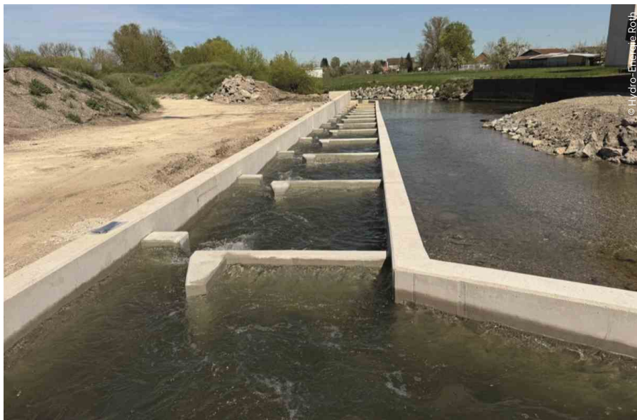
Ein moderner Vertikal-Slot-Pass mit 28 Becken ermöglicht den Fischen in der Riß den problemlosen und sicheren Aufstieg ins Oberwasser.
