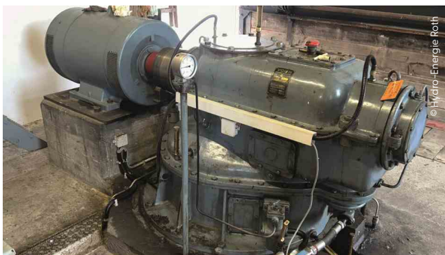
Die Francis-Schachtturbine aus den 60ern war noch in sehr gutem Zustand. Daher wurde sie professionell überholt und modernisiert.
