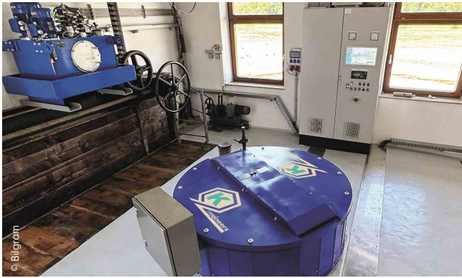
Die neue Steuerung kommt aus Resilienz-Gründen ohne Cloud-Technik aus.
