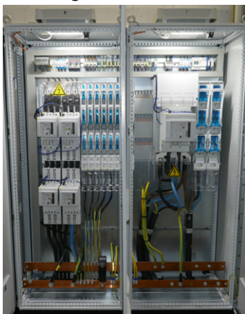
Leistungsschrank 2x 250 kW
